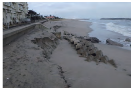
写真1 台風1919号襲来後の浜崖形成(皆生工区)
