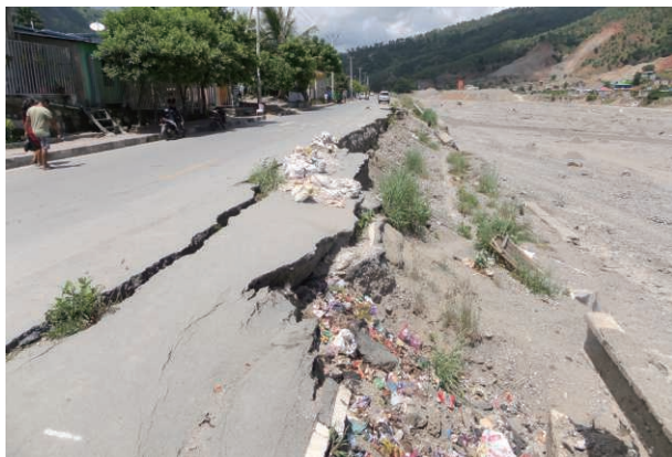
河岸浸食による護岸、道路の崩壊
