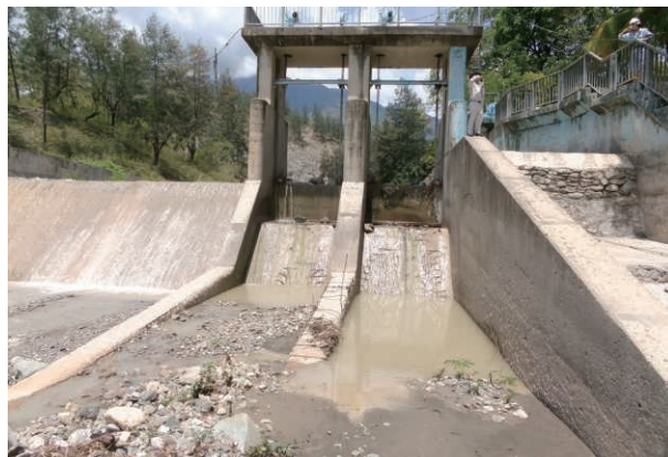
洪水時に流下する石等によってコンクリートが摩耗し鉄筋が露出した土砂吐きゲート
