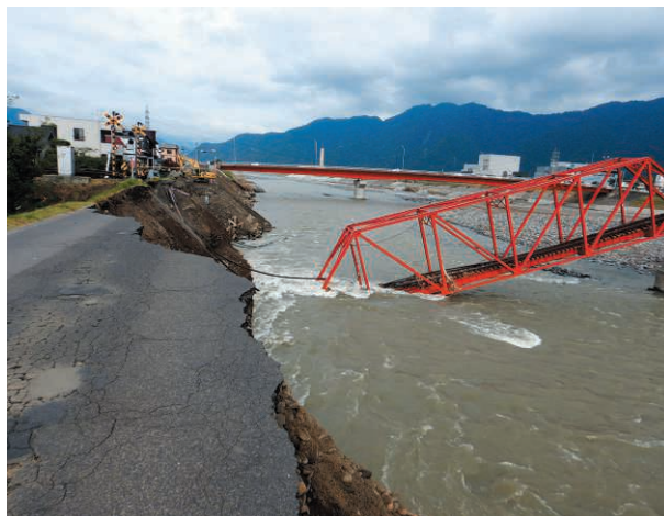
千曲川堤防欠損の状況（長野県上田市）
