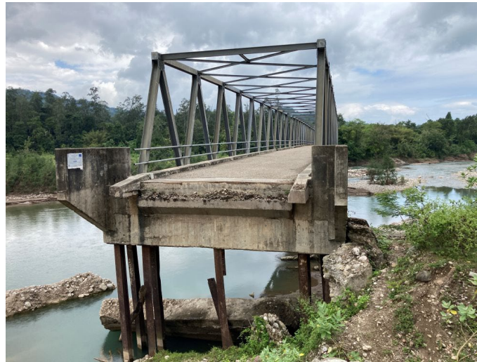
アプローチ道路が洪水によって流失した橋梁
